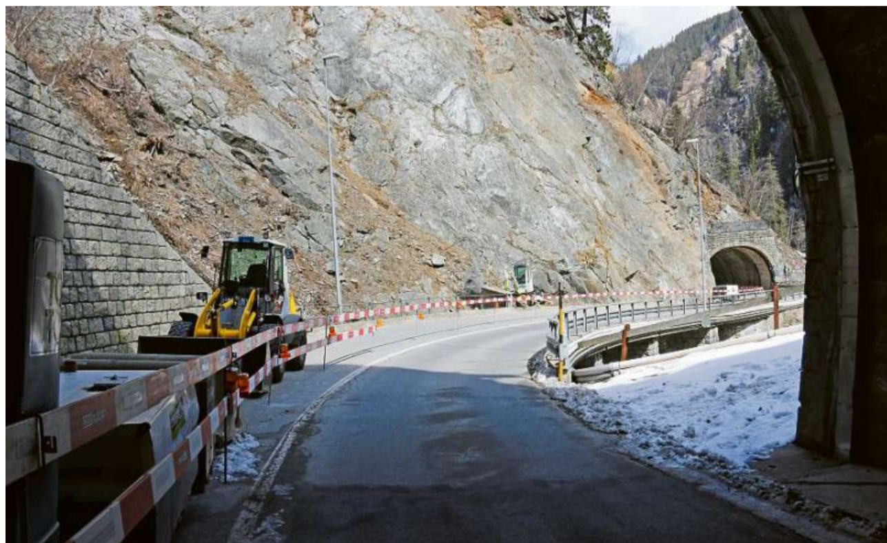
Seniester dil tunnel existent sesanfla il portal dil niev tunnel Las Ruinas. La fotografia datescha digl avrel 2024.
